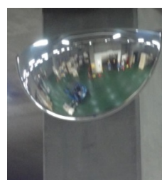
(エレベーター内から外の様子分かるように外の柱にミラーを設置)
